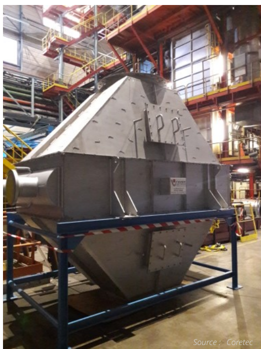
Echangeur sur fumées de four
